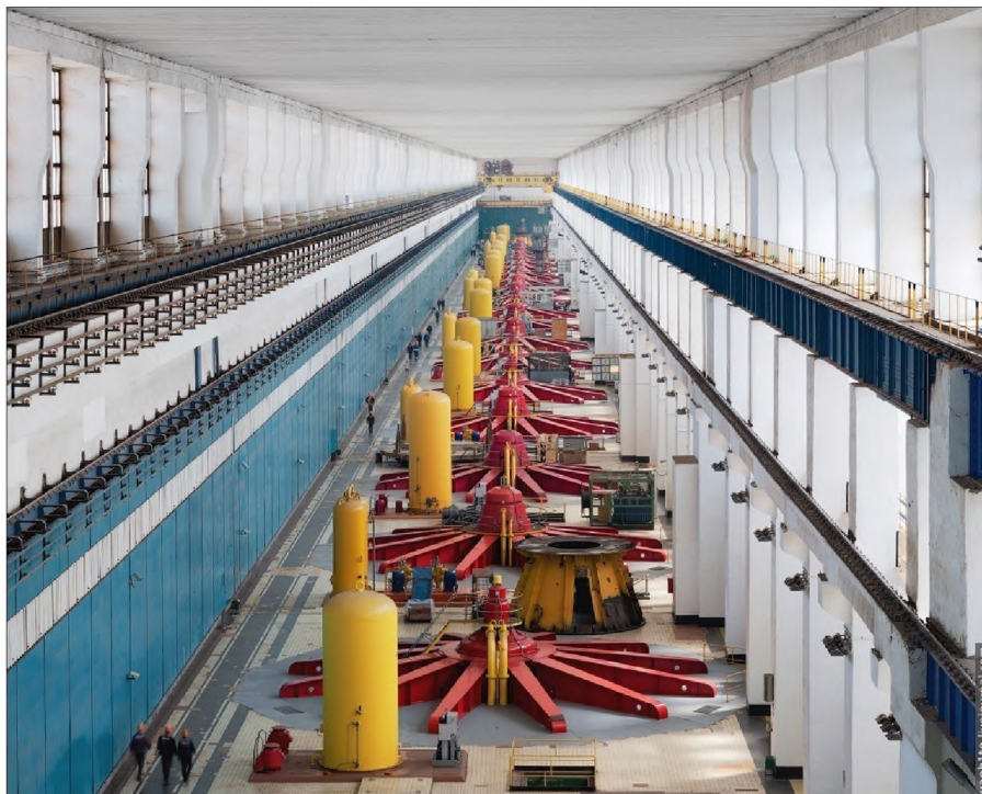
Рисунок 5.2 – Гидротурбины Воткинской ГЭС в машзале
